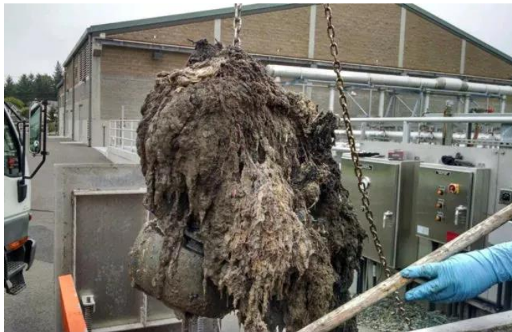
Dégrilleur d'une station de refoulement eaux usées saturé principalement par des lingettes.
